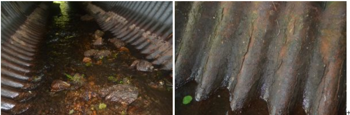
Vista do interior da PH com a solução original em chapa de aço corrugado e pormenor da oxidação e delaminação das chapas de bancada
